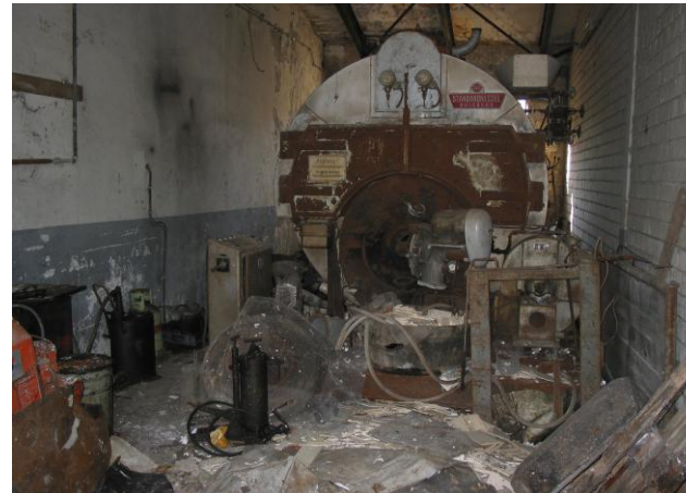
Liegt hier eine Verunreinigung mit Gefahrstoffen oder biologischen Arbeitsstoffen vor?
