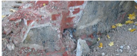
Kontaminiertes Baumaterial: die TRGS 524 ist in Ausschreibung und Ausführung zu beachten!
